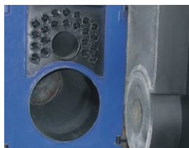
Caldeira de 3 passagens de fumo e baixo teor de NOx
